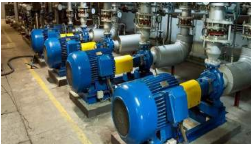
Рисунок 2 – Промышленные насосные установки и оборудование.
