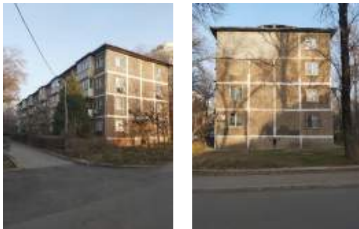
Рисунок 1 – Состояние панельных домов в микрорайоне 1, г. Алматы.
