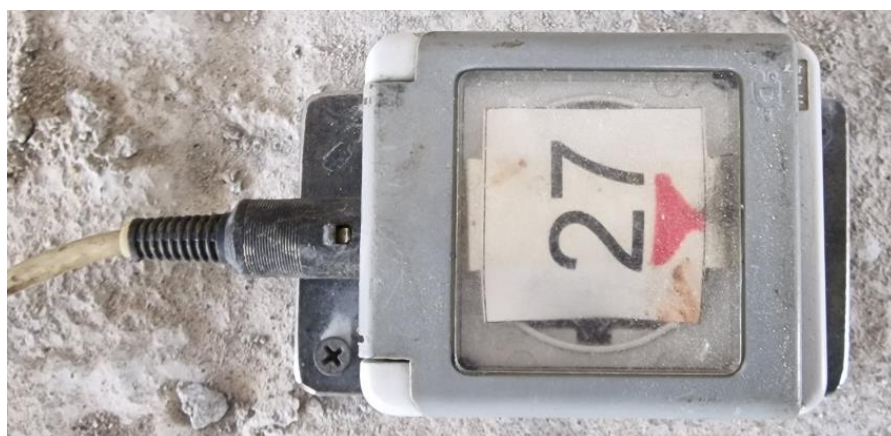
Рисунок 30 – Цифровой датчик, закрепленный на конструкциях здания
