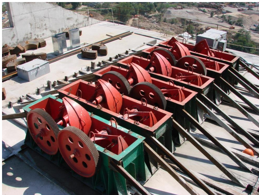
Рисунок 17 – Внешний вид вибрационной машины, установленной на перекрытии
