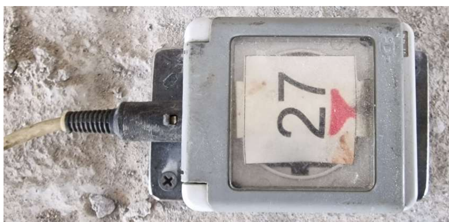
Рисунок 29 – Цифровой датчик, закрепленный на конструкциях здания
