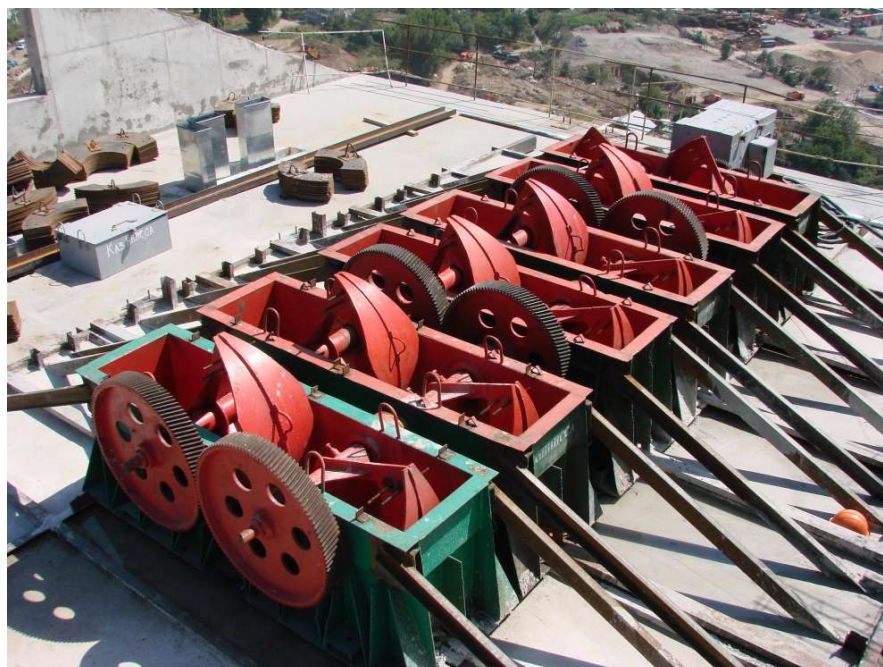
Рисунок 16 – Внешний вид вибрационной машины, установленной на перекрытии
